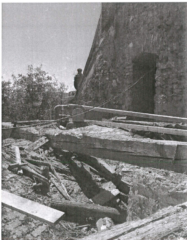
Az eredeti tetőszerkezet korhadt fa elemei
