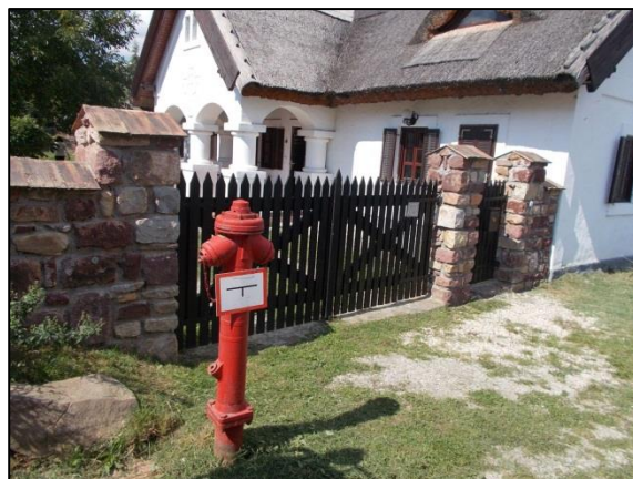
Tűzcsap – Petőfi út 4.
